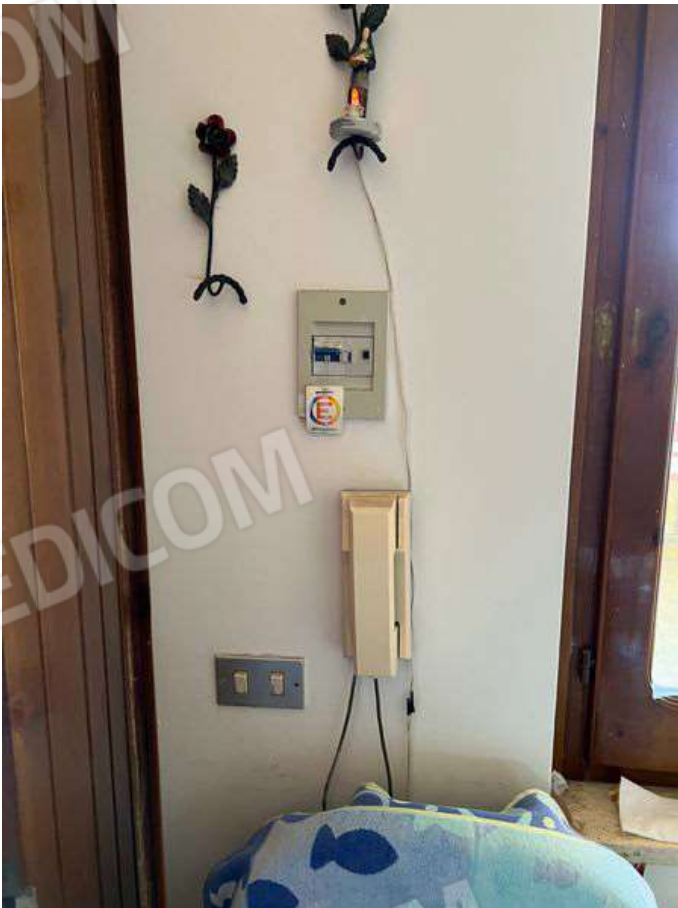
Foto 22 – Particolare quadro elettrico e impianto citofonico
