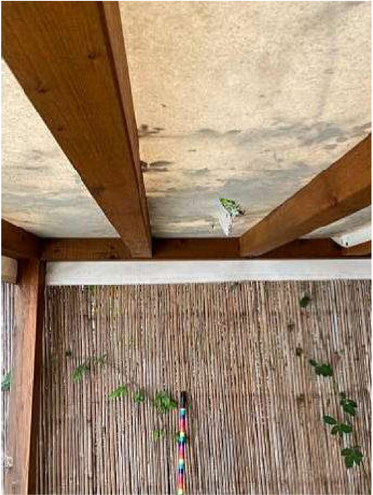
Figura 4. Fotografia scattata ad una delle coperture in PVC in cui si evidenzia la struttura lignea e uno strappo al telo in PVC
