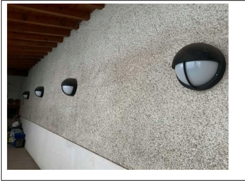
n. 5 lampade applique da parete del portico
